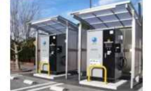
蓄電池・充電施設
