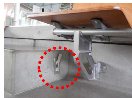
集団補聴設備の設置
