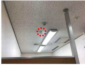
トイレ内設置状況
