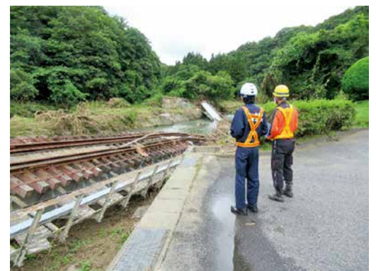
JR西日本・美祢線の橋梁流出現場調査
