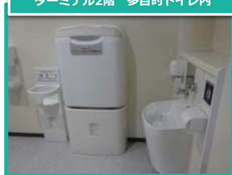
ターミナル2階 多目的トイレ内
