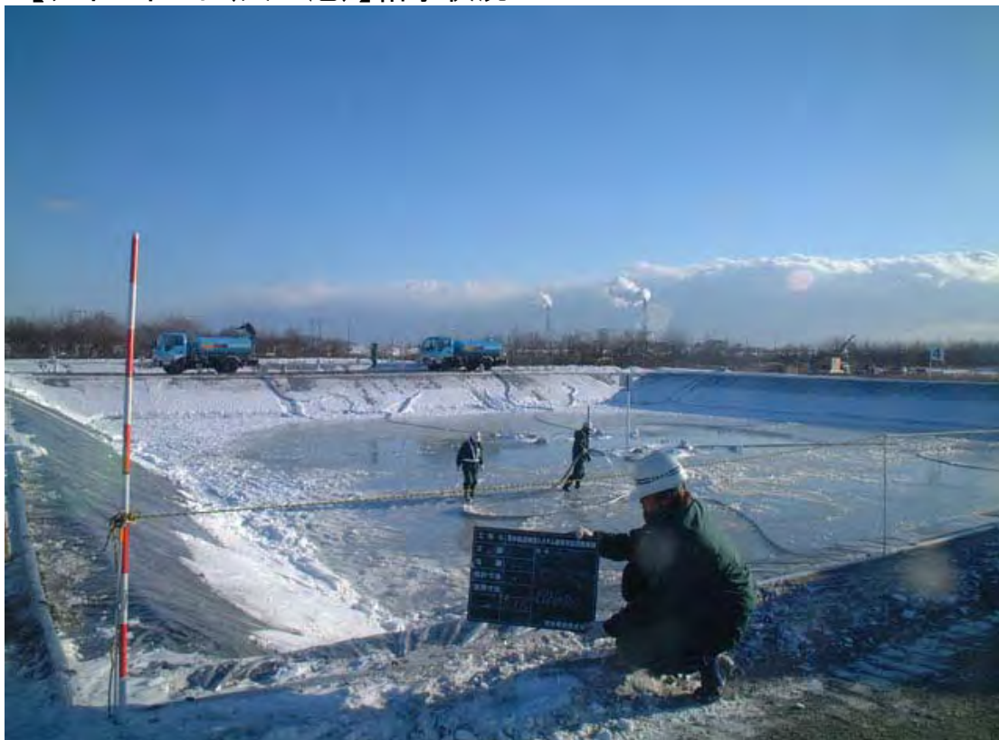
【アイスpond(人工池)】給水状況
