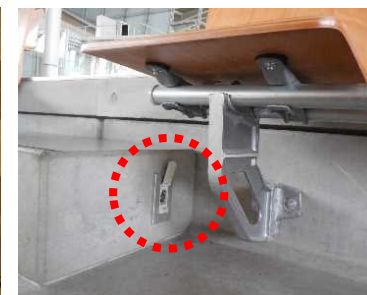
集団補聴設備の設置
