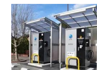
EVバス充電設備
