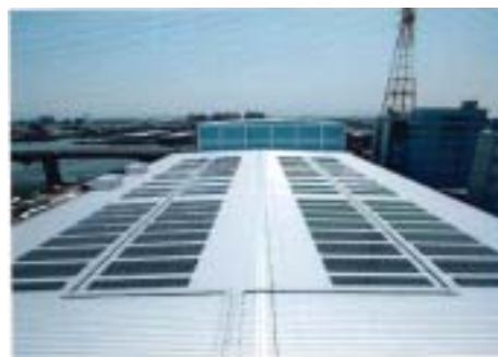
太陽光パネル
