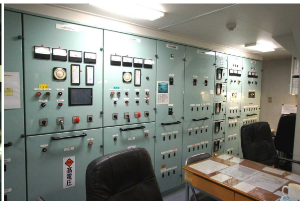
【エンジンコントロールルーム】
