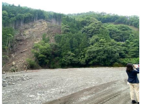
川津高野線733号の崩落箇所2
