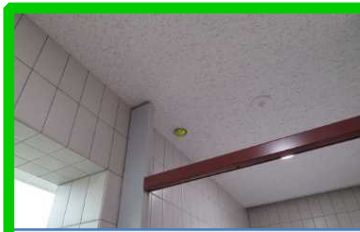
緊急時に点滅するランプ
