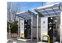
EVバス充電設備
