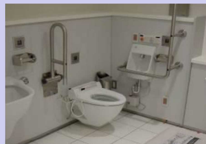
障害者対応型トイレ
