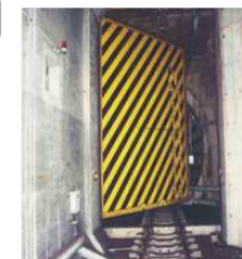
トンネル内防水ゲート
