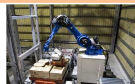
ピッキングロボット
