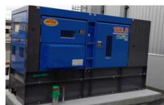
非常用電源設備
