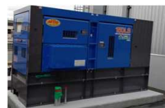
非常用電源設備
