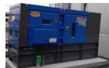
非常用電源設備
