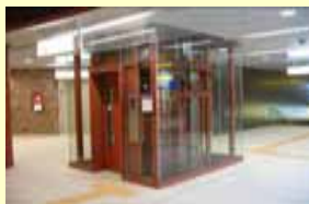
エレベーター
