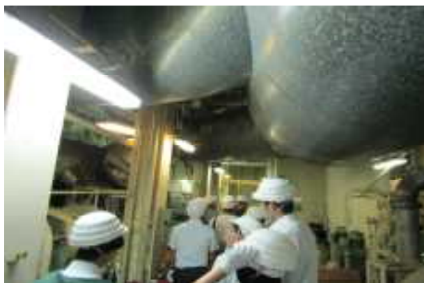
太いパイプが通る機関室
