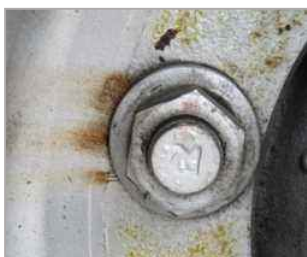
さび汁が流出した痕跡
