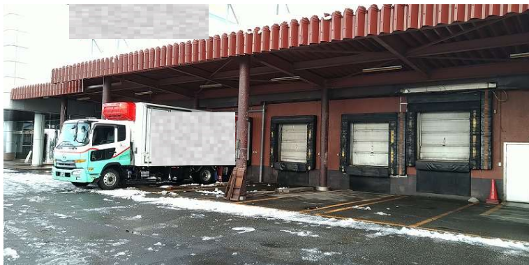
全ての出荷バースはドックシェルター
