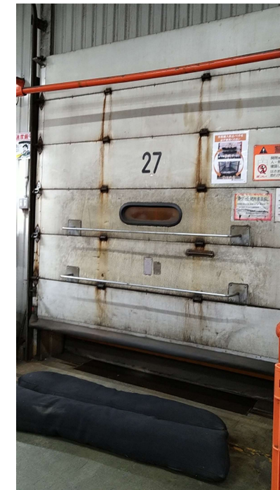
1/22 10:58 バス側のドックシェルターの ドアを閉めた様子
