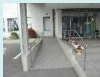
出入口の段差解消 事業費：30万円程度
