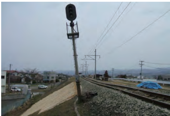
写真 2.6.2 保原駅場内信号傾斜
