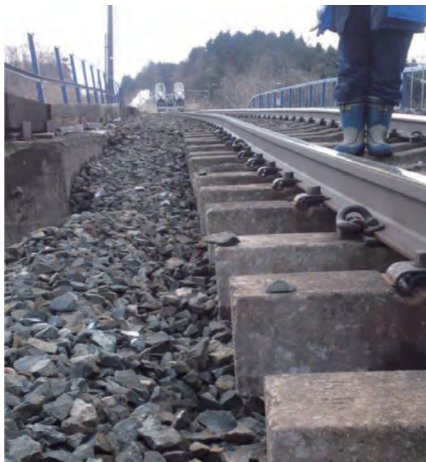
写真 2.7.1 滝沢駅～洪民駅間道床流失状況
