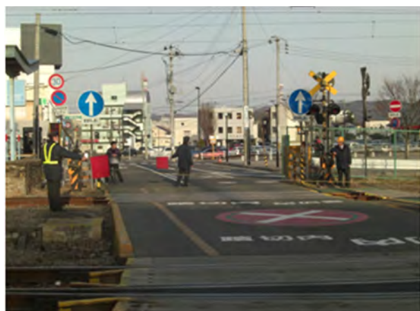
写真 2.8.2 曾根田東踏切での踏切防護
