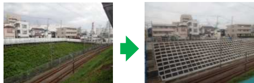
落石等防止設備（法面固定）
