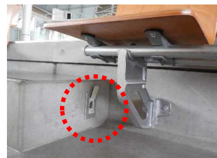
集団補聴設備の設置
