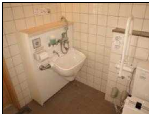
バリアフリートイレの整備
