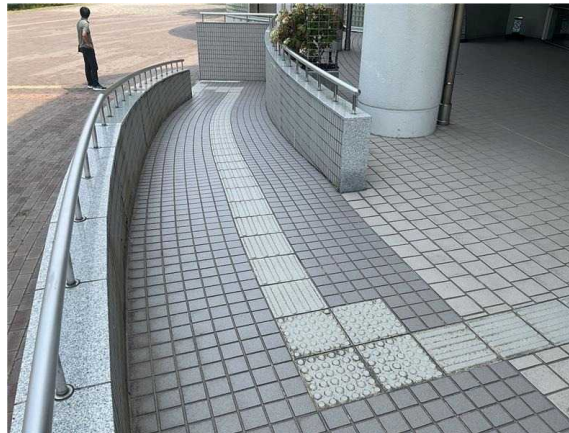
トリムパークかなづ（あわら市）改修前
