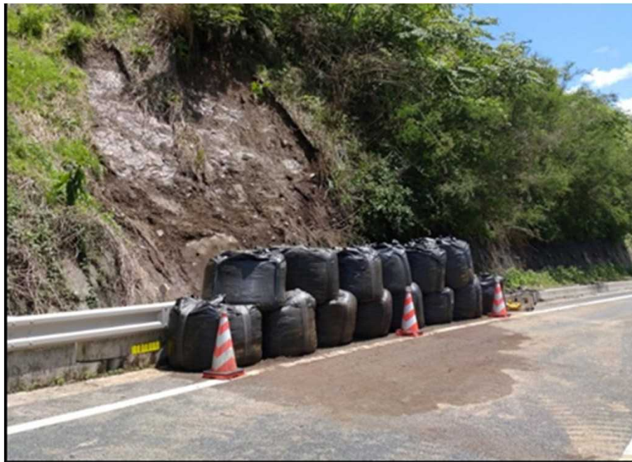
【土砂流入】 国道474号浜松市天竜区佐久間町
