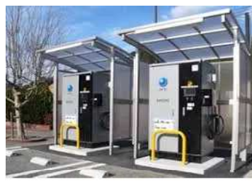
EVバス充電施設の設置
