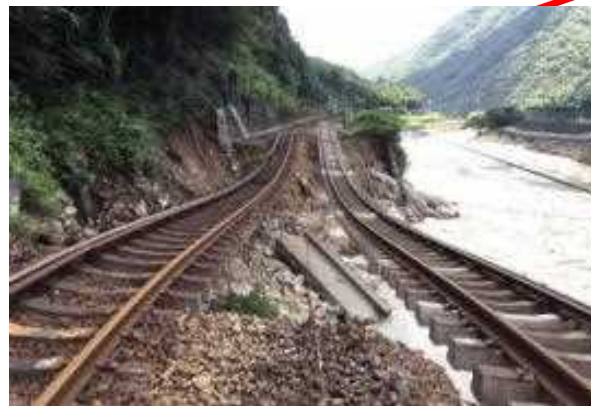
本郷～河内駅間 盛土流出
