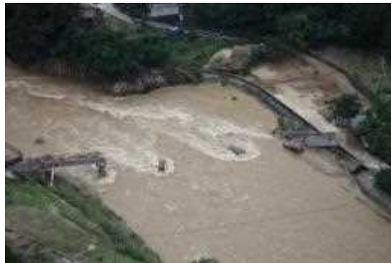
白木山～狩留家駅間 第1三篠川橋桁流出 新岩国
