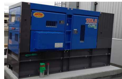
<非常用電源設備>
