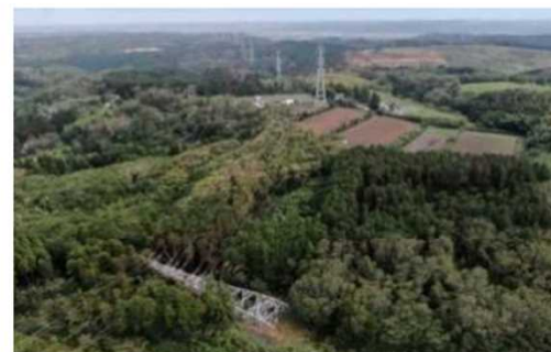
台風15号により倒壊した鉄塔
