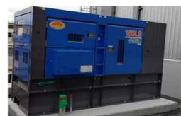
非常用電源設備
