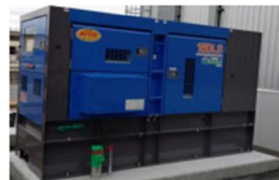
<非常用電源設備>
