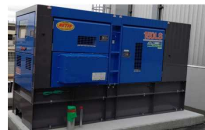
＜非常用電源設備＞
