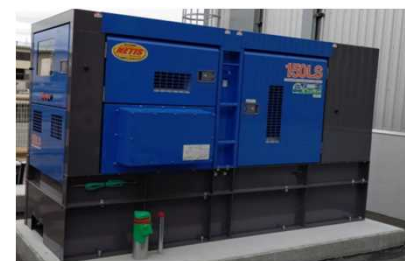
＜非常用電源設備＞
