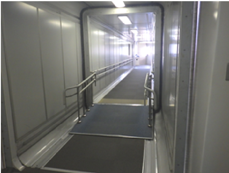
◇ 更新前 P B B 伸縮部分に段差
