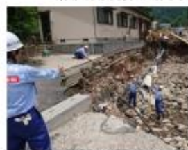
河川被害状況の調査
