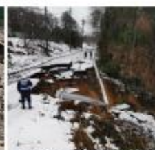
道路被害状況の調査
