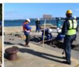
港湾被害状況の調査
