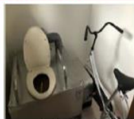
バイオトイレの整備
