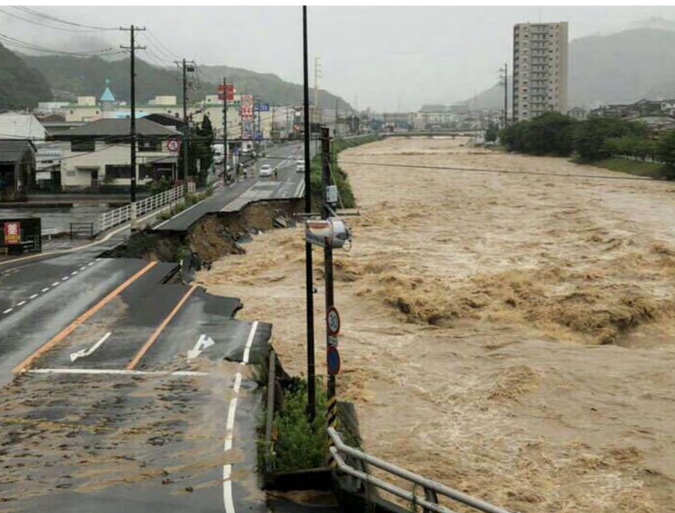
河川護岸崩壊により通行止め 【広島県広島市安芸区】(一般国道2号)
