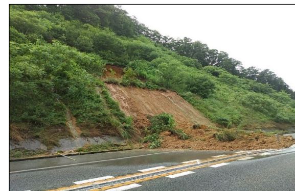
大雨による法面崩落 松江道 広島県庄原市高野町 令和3年7月12日
