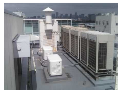
（ANH 本社屋上電源設備）
