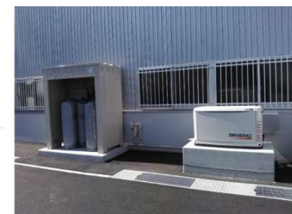
（ANH 福岡基地電源設備）
