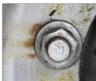
さび汁が流出した痕跡
