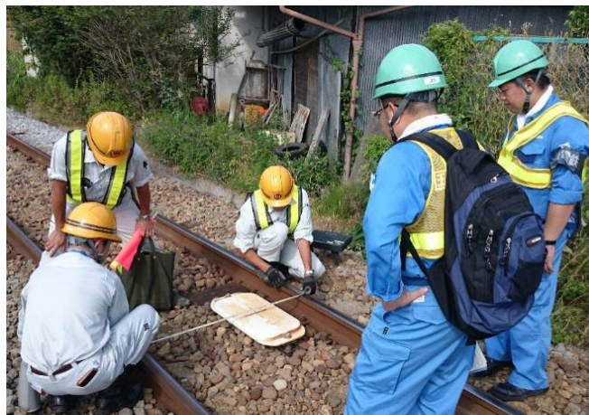
電気：ATS地上子測定
