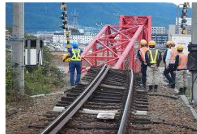
鉄道施設被害調査
