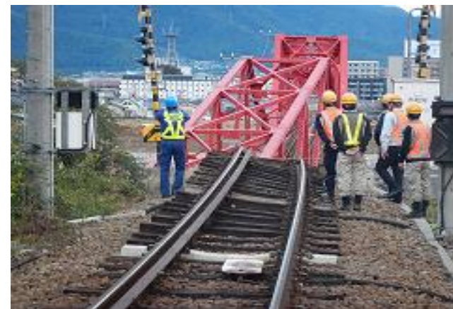
鉄道施設被害調査
