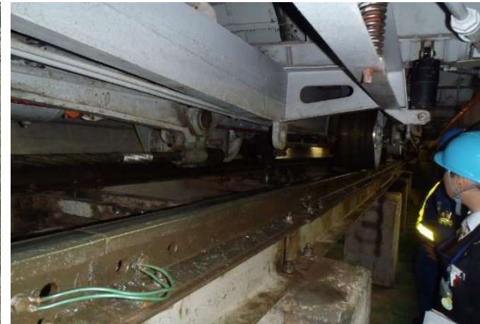
車両：検査施設
