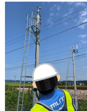
電気：保安監査（風速計）
