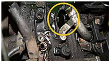
<エンジンの破損状況>
