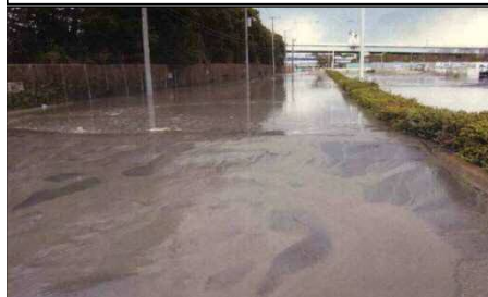
東扇島幹線5号道路液状化
