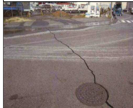
東扇島幹線5号道路亀裂
