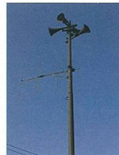
防災行政無線の設置 (臨港地区内23基追加)
