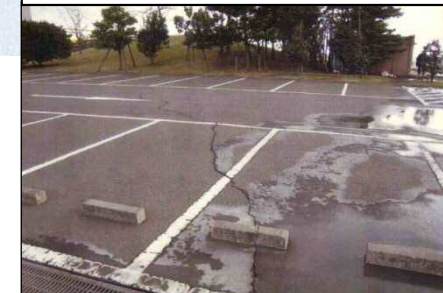
東扇島西公園駐車場亀裂
