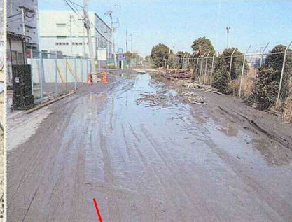
東扇島8m緑地前道路液状化
